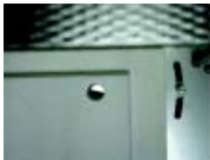
Zuluftöffnung in der Tür
