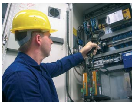
Anwendung: Elektrische Instandhaltung Vorbeugende Instandhaltung von elektrischen Systemen, Motoren und Schaltschränken.
