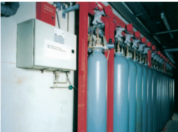
CO 2 -Hochdrucklöschanlage mit pneumatischer Zeitverzögerung
