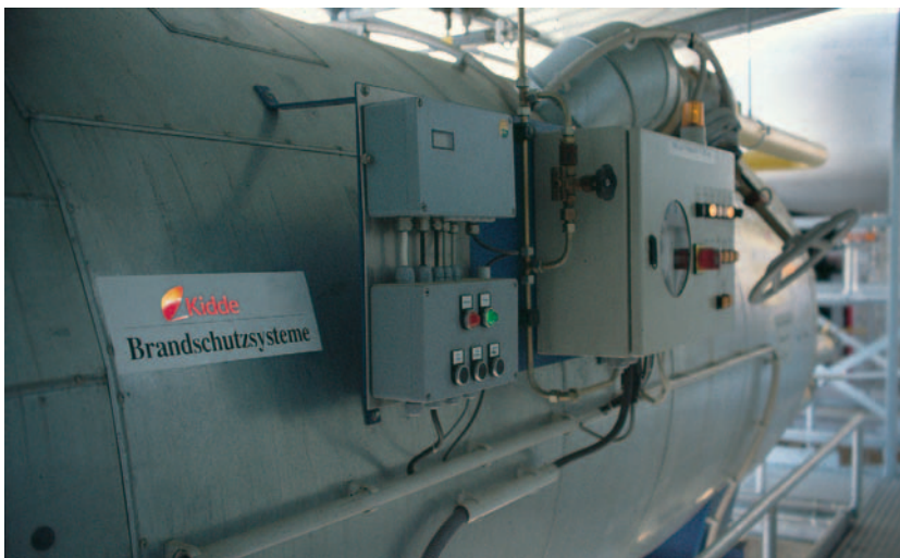
CO 2 -Vorratsbehälter mit Schaltschränken
