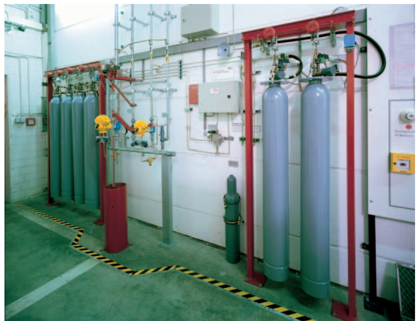
CO 2 -Flaschenbatterie mit Bereichsventilen und pneumatischer Zeitverzögerung
