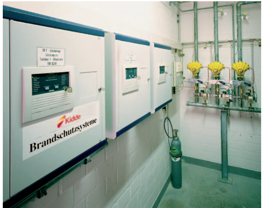
Bereichsventile mit Brandmeldezentralen
