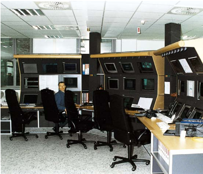
KD-200-Löschanlage für einen Operator-Raum
