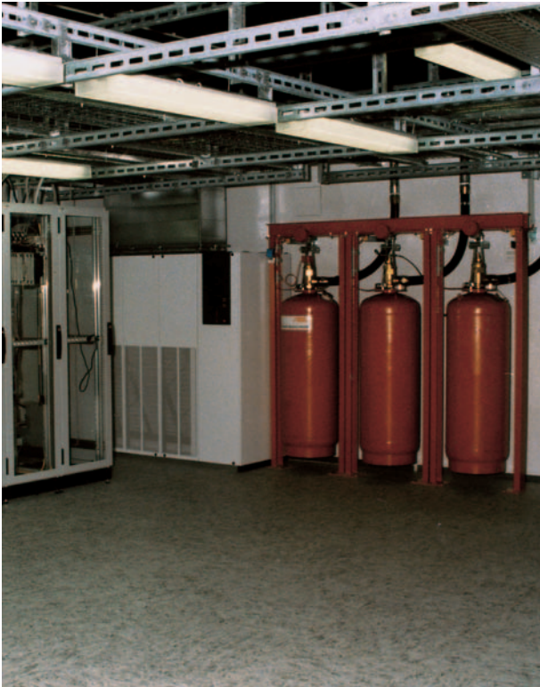
KD-200-Löschanlage für einen EDV-Raum
