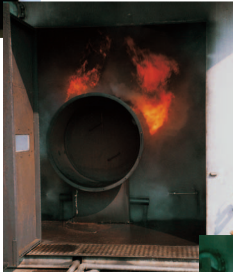
Sofortiges Eindämmen der Flammen nach Auslösung des AquaSafe-Systems
