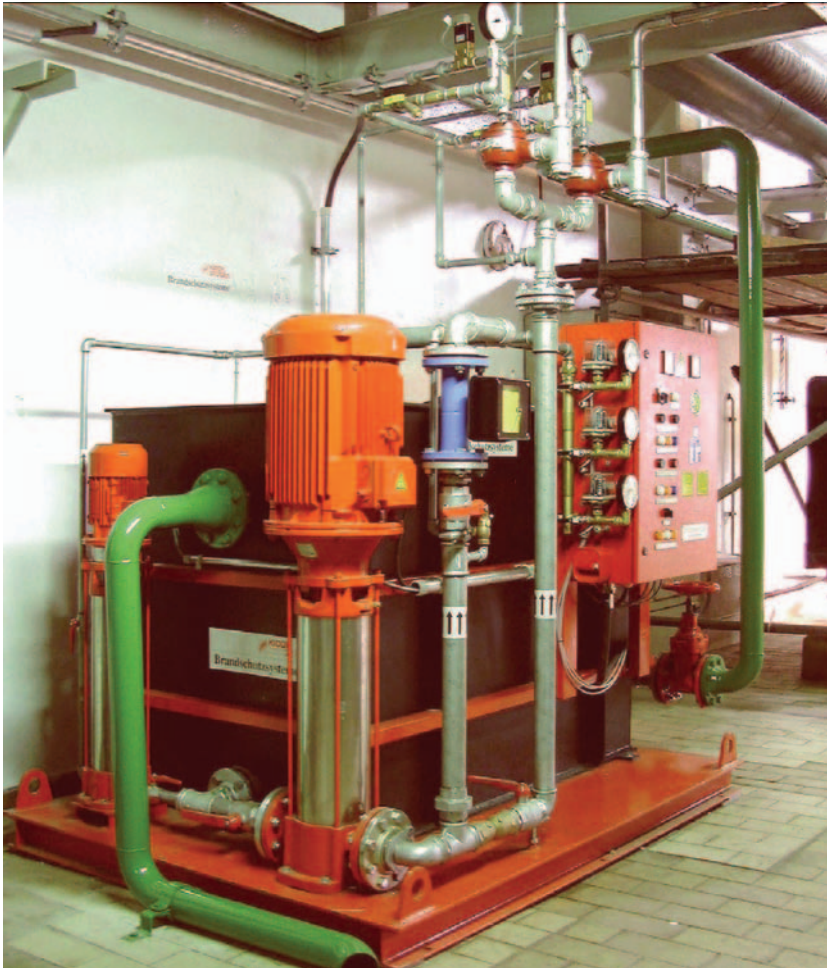
Pumpenaggregat mit Vorratsbehälter
