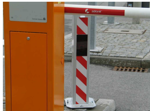
Car-Reader Säule an einer Schranke installiert
