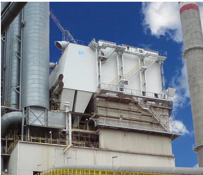
Nowiny, Polen (Dyckerhoff) Umbau Elektrofilter Zwei CombiJet Doppelfilter in offline Abreinigung Entstaubung Drehrohren
