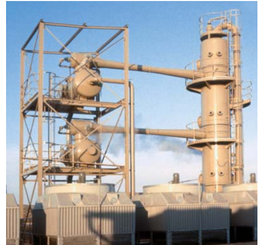
Bild 9: 3-stufige Dampfstrahl-Kühlanlage in Brückenbauweise, Kühlung von 194 m 3 /h Wasser von 28 auf 15 °C, Kälteleistung: 2 900 kW
