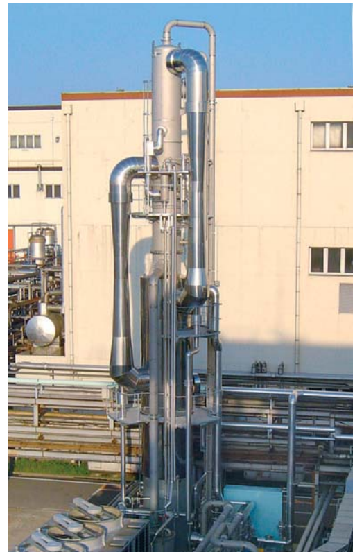
Bild 7: 2-stufige Dampfstrahl-Kühlanlage in Turmbauweise, Kühlung von 200 m 3 /h Wasser von 10 auf 5 °C Kälteleistung: 1163 kW
