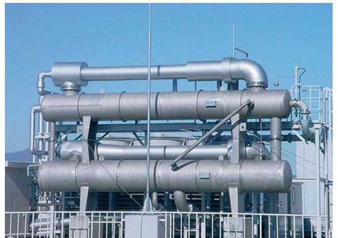
Bild 5: 2-stufige Dampfstrahl-Kühlanlage in Kompaktbauweise, Kühlung von 44 m 3 /h Wasser von 30 auf 10 °C
