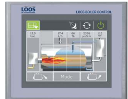
Touch Screen Display der Kesselsteuerung LOOS BOILER CONTROL LBC
